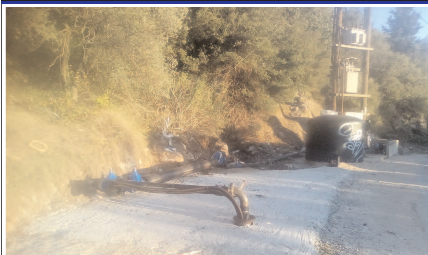
Η νέα γεώτρηση στο Καρτέρι. Εκτεθειμένα ΟΛΑ δίπλα στον επαρχιακό δρόμο!
