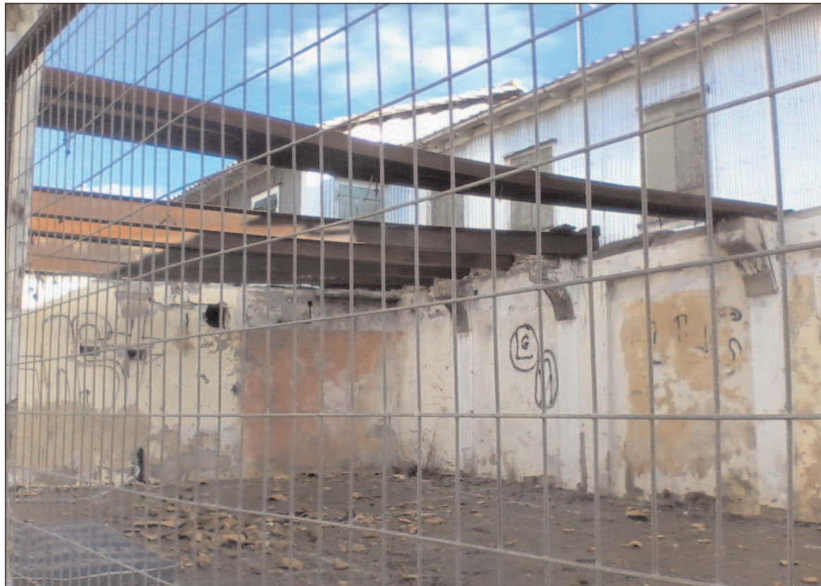
Ότι απέμεινε από τον δημοτικό κινηματογράφο Απόλλων μετά την πυρκαγιά του 2015
