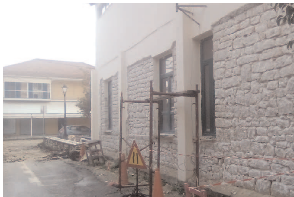
Στη φωτογραφία από την καθαίρεση του επιχρισματος στον εξωτερικό τοίχο του κτιρίου, που γίνεται με έργο σε εξέλιξη
