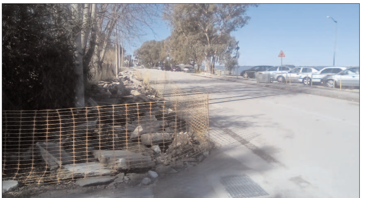
ΠΑΝΩ. Τα πεζοδρόμια στο 1ο Δημοτικό και το Γυμνάσιο. Τα πεζοδρόμια τελείωσαν όμως ο δρόμος πλυμμουρίζει αφού δεν φρόντισαν για την παροχέτευση των ομβρίων. ΣΤΗ ΜΕΣΗ. Το αδιάβατο πεζοδρόμιο μπροστα στο Δικαστικό Μέγαρο ΚΑΤΩ. Το αδιάβατο πεζοδρόμιο από τα Δικαστήρια μέχρι τα σχολεία.
